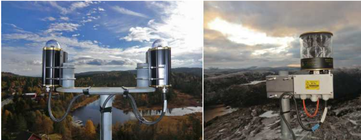
Figura 1.1 Luces de obstáculos de aviación Obelux de baja y media intensidad LED en mástiles de telecomunicaciones en Noruega
