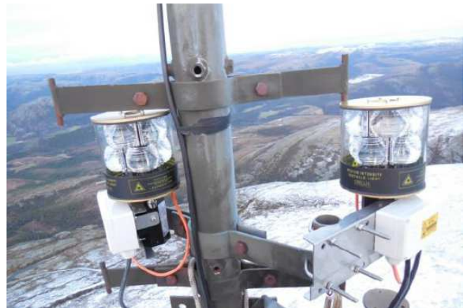
Figura 1.2 Las luces de obstáculos de aviación Obelux LED ahorran sustancialmente los costos de energía y mantenimiento en comparación con las luces tradicionales.
